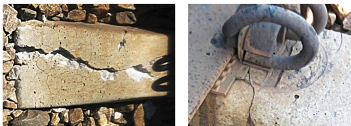
Рис. 2. Тріщини у залізобетонних шпалах: а – дрібна сітка тріщин від внутрішньої корозії і велика подовжня тріщина у кінці шпали; б – поперечна тріщина в зоні анкера
