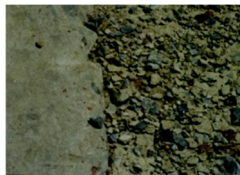
Рис. 2. Частина литого покриття дорожнього полотна (м. Тернопіль, Україна). Матеріал: бетон на основі шлаколужного цементу (ліворуч), для порівняння - бетон на основі портландцементу (праворуч). Споруджено в 1984 р. Фото зроблено в 2000 р.
